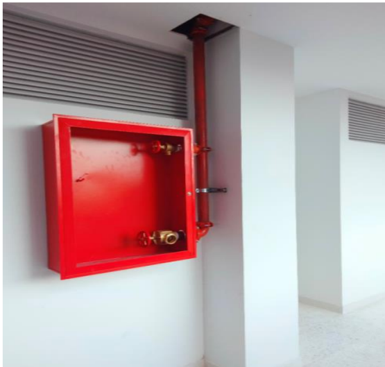
Foto 17. Instalación de gabinete con puntas expuestas
