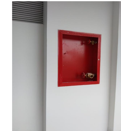
Foto 20. Gabinete tipo III red contra incendios piso 3 bloque 1, con muros en superboard
