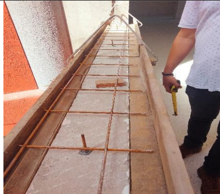
Foto 1. Colocación de refuerzos y anclajes con epóxido para soporte de alfajas en el piso 2 del bloque 1.
