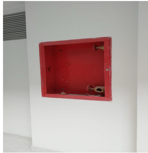
Foto 18. Gabinete tipo III red contra incendios piso 1 bloque 1 con muros en superboard.
