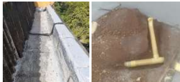
Ilustración 4. TUBERIA DESAGUE SEDE NEIVA
